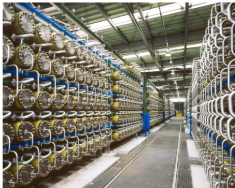
海水淡水化プラント
