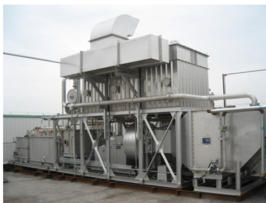
VOC回収装置
