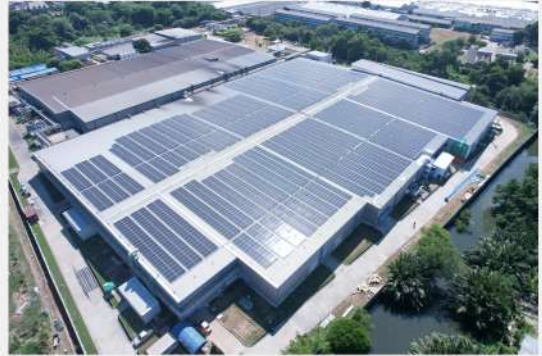
TSSW の屋上に設置された太陽光パネル 発電容量約 2,300kW
