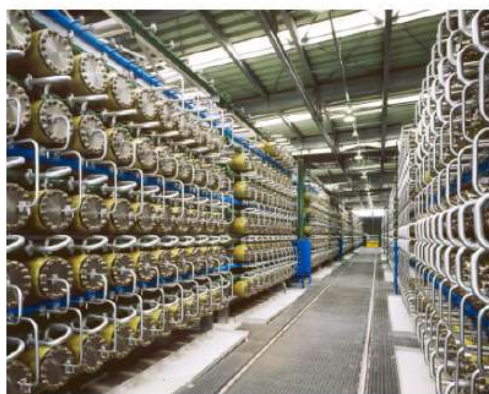
海水淡水化プラント
