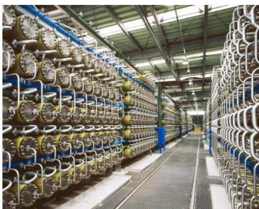
海水淡水化プラント
